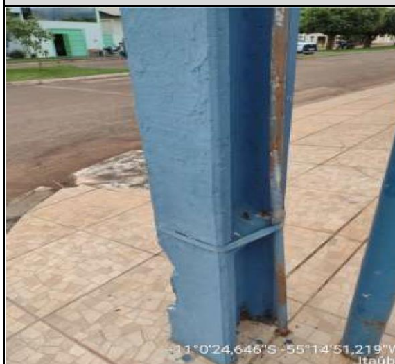
(imagem do local de instalação do dispositivo)
