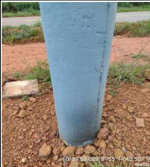
(imagem do local de instalação do dispositivo)
