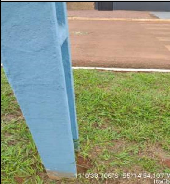
(imagem do local de instalação do dispositivo)
