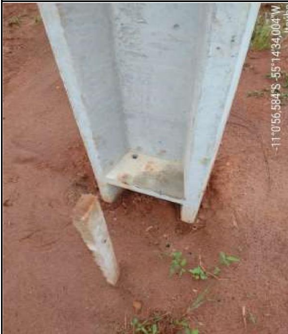
(imagem do local de instalação do dispositivo)
