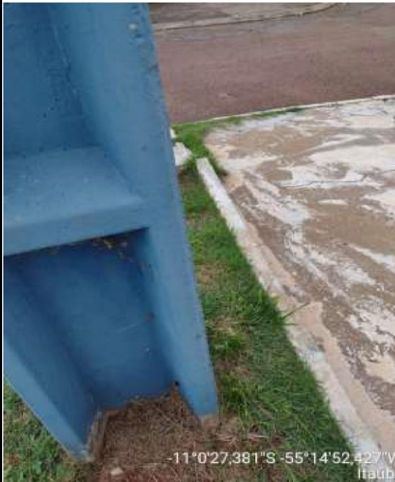
(imagem do local de instalação do dispositivo)
