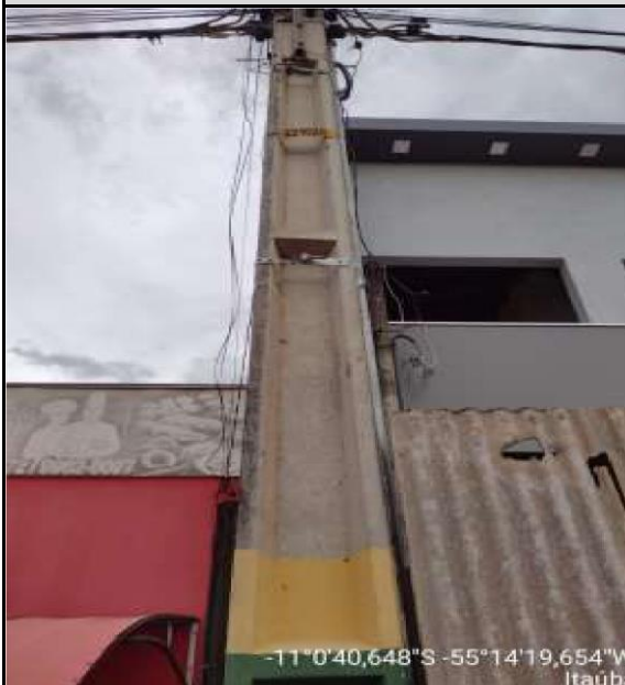
(imagem do local de instalação do dispositivo)
