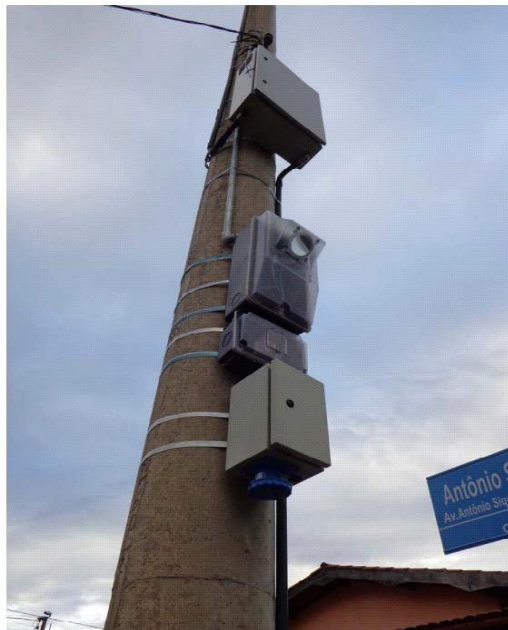
Figura 6.1 – Caixa de Medição
